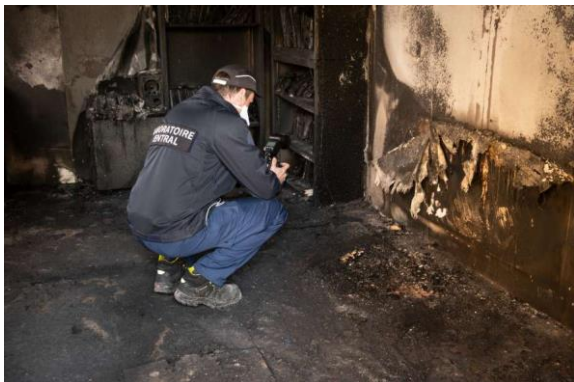
Prise de vue par les équipes du LCPP pour figer les investigations après incendie
