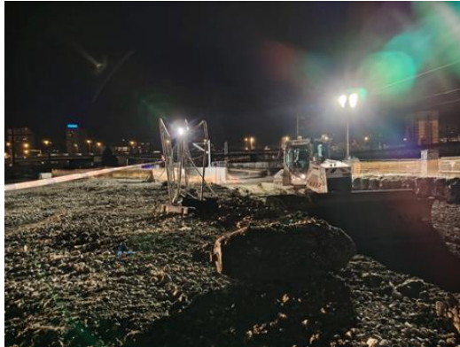
La bombe découverte en pleine nuit sur un chantier SNCF
