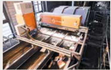
3 Séparation automatique des différents types de déchets (tri magnétique, granulométrique, balistique et optique).
