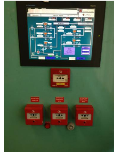
Déclencheurs manuel dans la salle de contrôle
