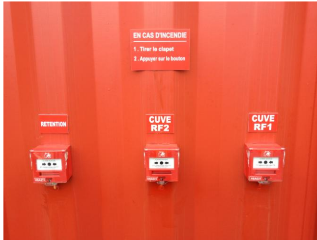
Déclencheurs manuel sur container
